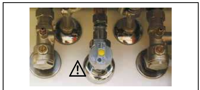
Figura: Conexión de gas: peligro de intoxicación y de explosión por escape de gas
