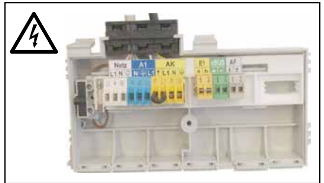
Bild: Klemmkasten, Gefahr durch elektrische Spannung
