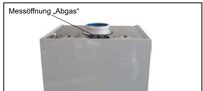
Bild: Abgasmessung bei geschlossenem Gerät
